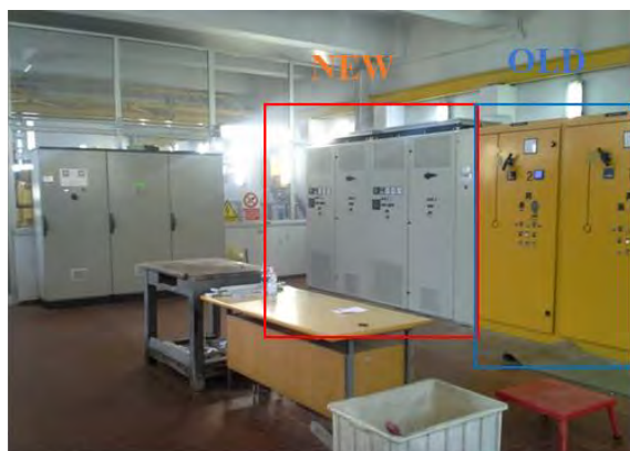
a. Abbiategrasso pump inverters
