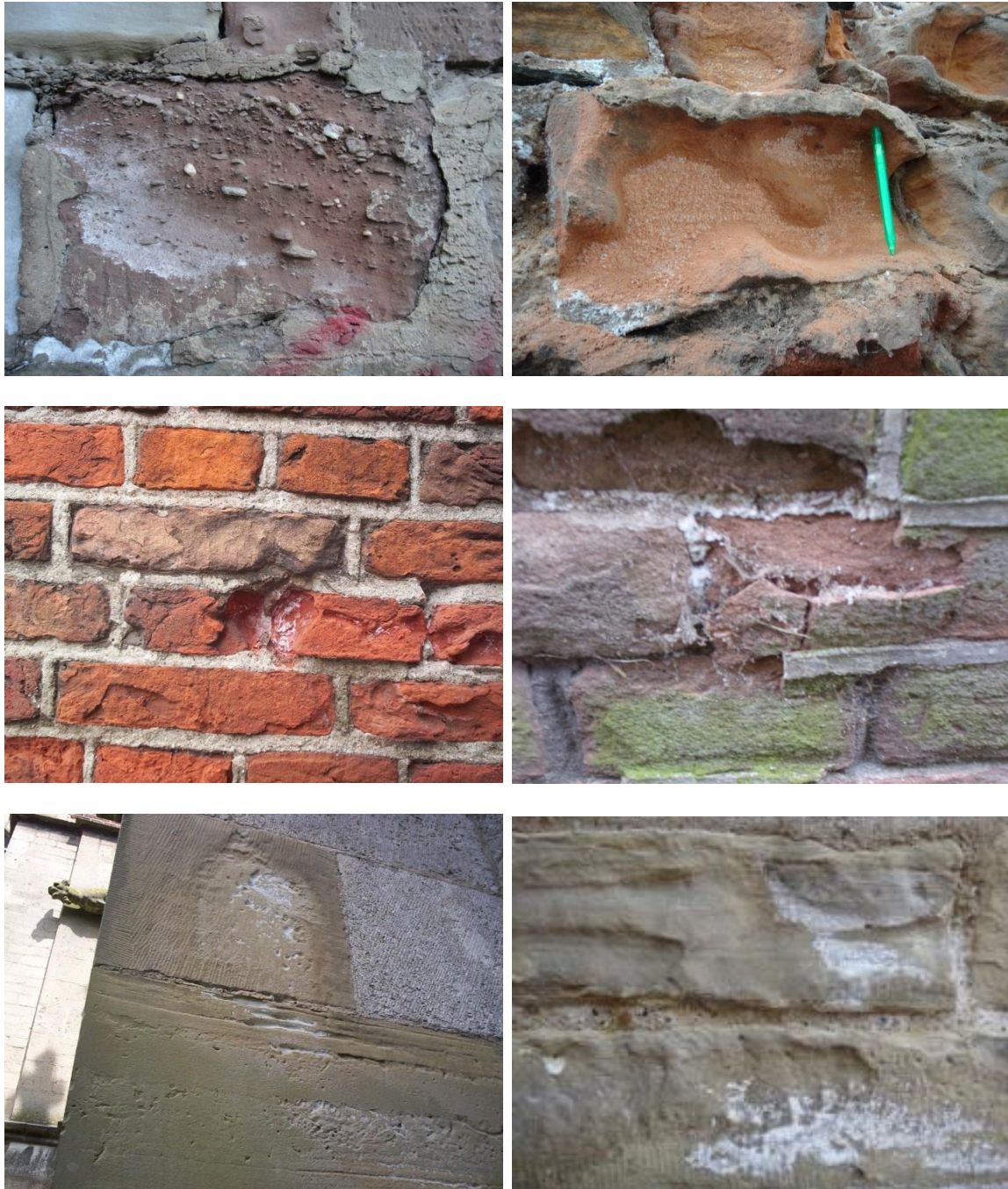
Fig. 7. Voorbeelden van zoutschade. Bovenste rij: verpoederen en sterk terugververen van Bontzandsteen, links aan de Römerbrücke in Trier (2012), rechts op de Schlossberg in Saarburg (2012). Middelste rij: links vergelijkbare schade aan baksteen van de Hooglandse kerk in Leiden (2005), rechts schade aan gehydrofobeerd baksteen metselwerk van pakhuis Zondag in Amsterdam (2008). Onderste rij: selectief ververen van Udelfanger zandsteen: de ene laag wel, de andere niet; links aan de pandhof van de Dom in Utrecht (2005), rechts aan de St. Jan in Gouda (2013).
