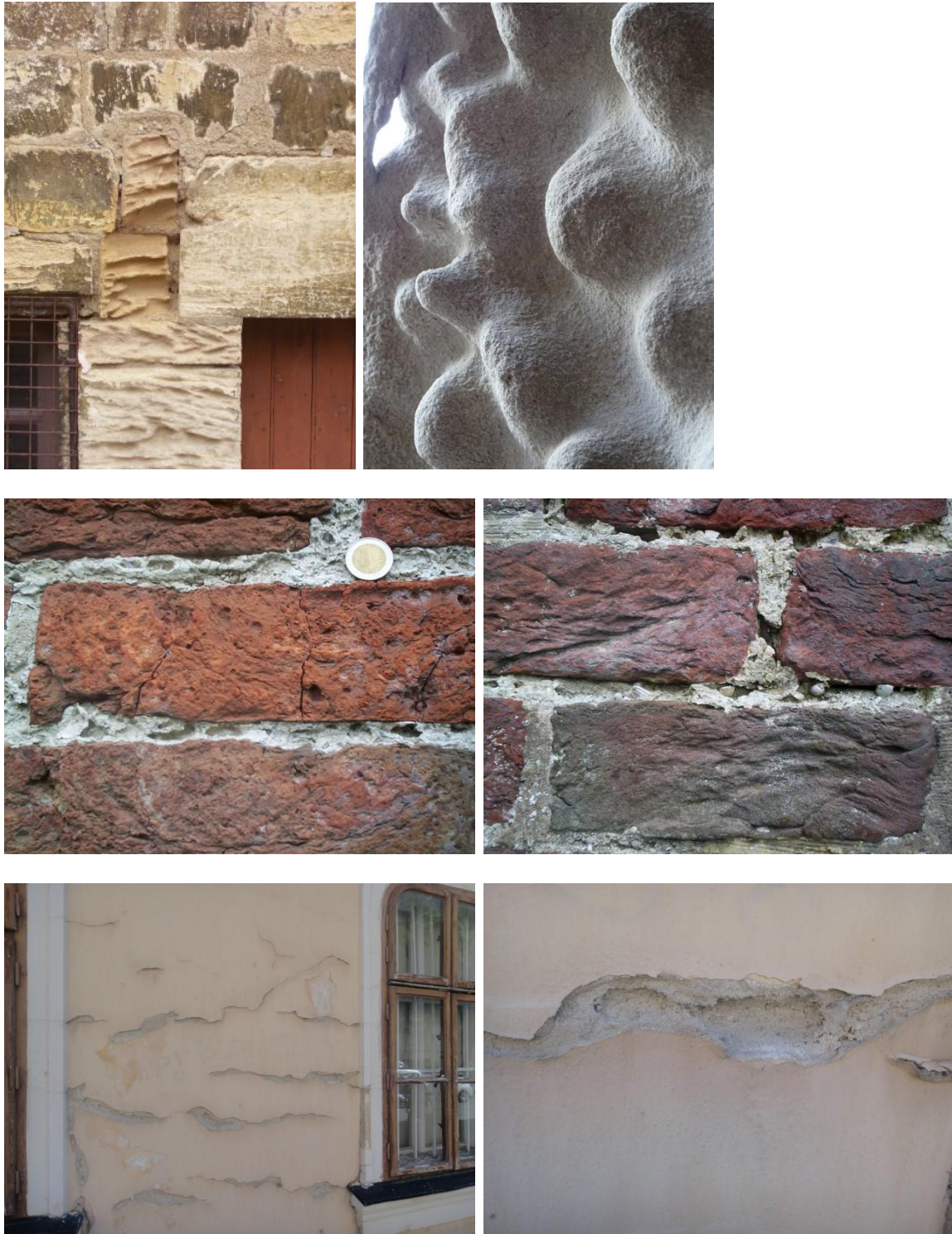
Fig. 7 (vervolg). Voorbeelden van zoutshade. Bovenste rij: alveoli in links Savonnières kalksteen, Place St. Pierre 2, Bar le Duc (2010) en rechts Obernkirchener zandsteen, Nieuwe Badkapel, Scheveningen (2017). Middelste rij: alveoli in mortel, links aan de Laurentiuskerk in Baflo (2004), rechts aan de NH Kerk in Hoorn, Terschelling (2005). Onderste rij: zoutshade aan pleister, Frantiskanske namestie 4, Bratislava (2014).
