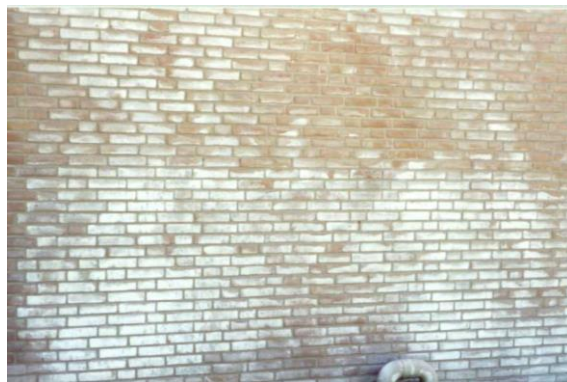
Fig. 5. Vergipsing op metselwerk.
