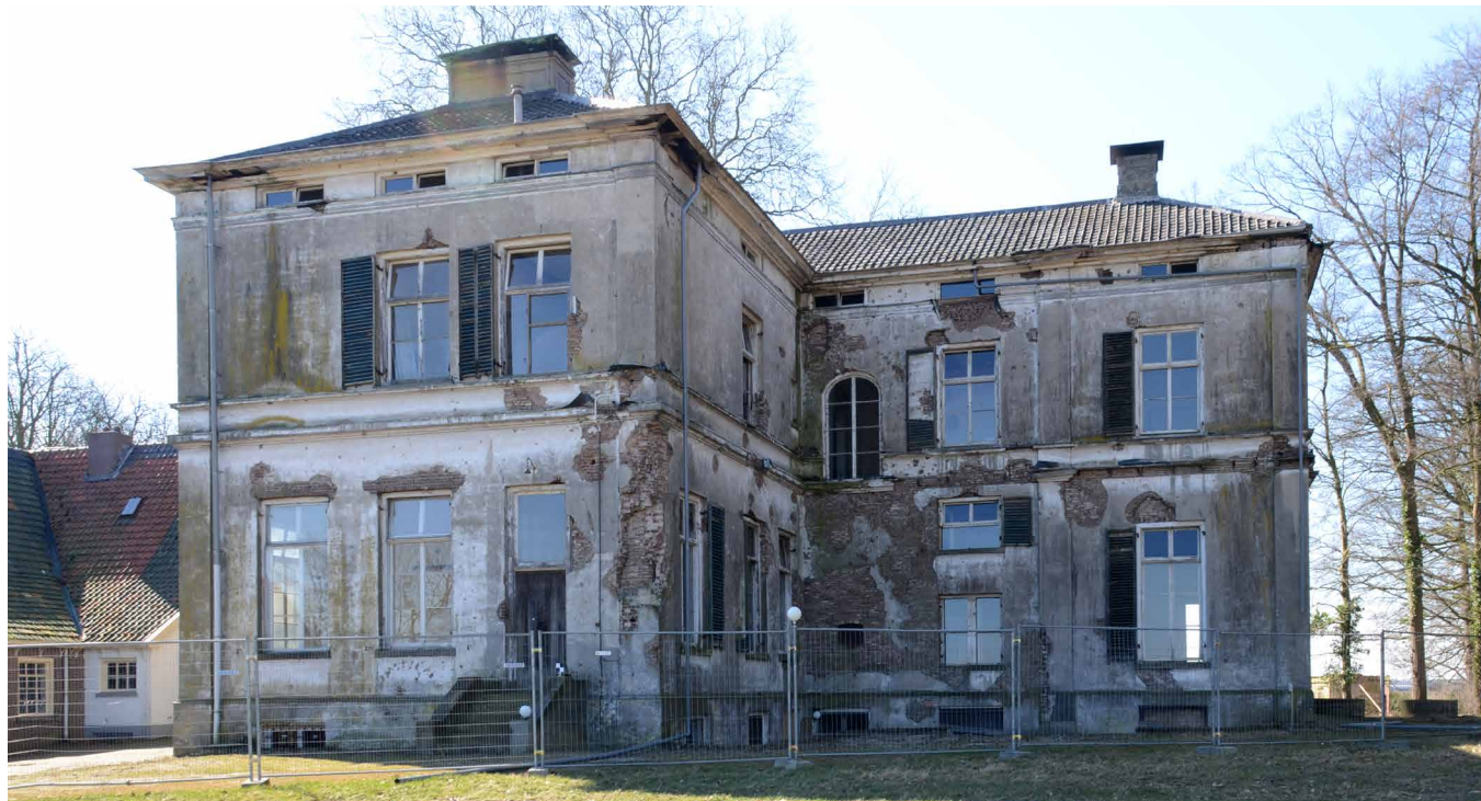
AFB. 7.8 Achtergevel Reuversweerd 'voor' de restauratie (Wido Quist).
