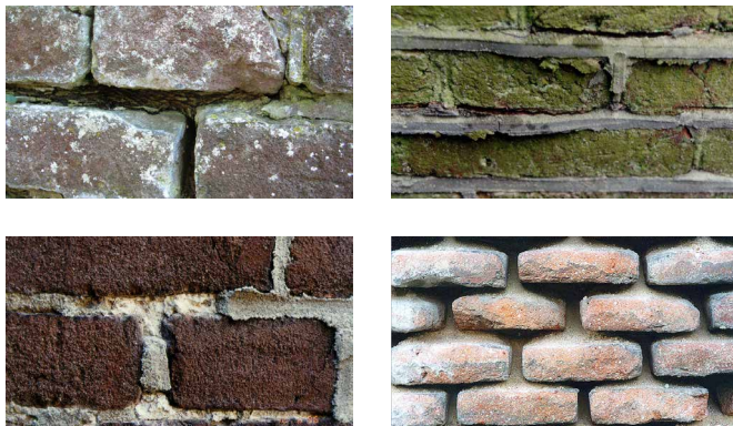
AFB. 4.6 Diverse typen van schades van linksboven tot rechtsonder: delaminatie van metselmortel en uitdrukken van de voeg; hechtingsverlies voeg - baksteen met gelijktijdige vervorming van voeg; uitdrukken van de voeg; verzanding van de voeg (MDCS).
