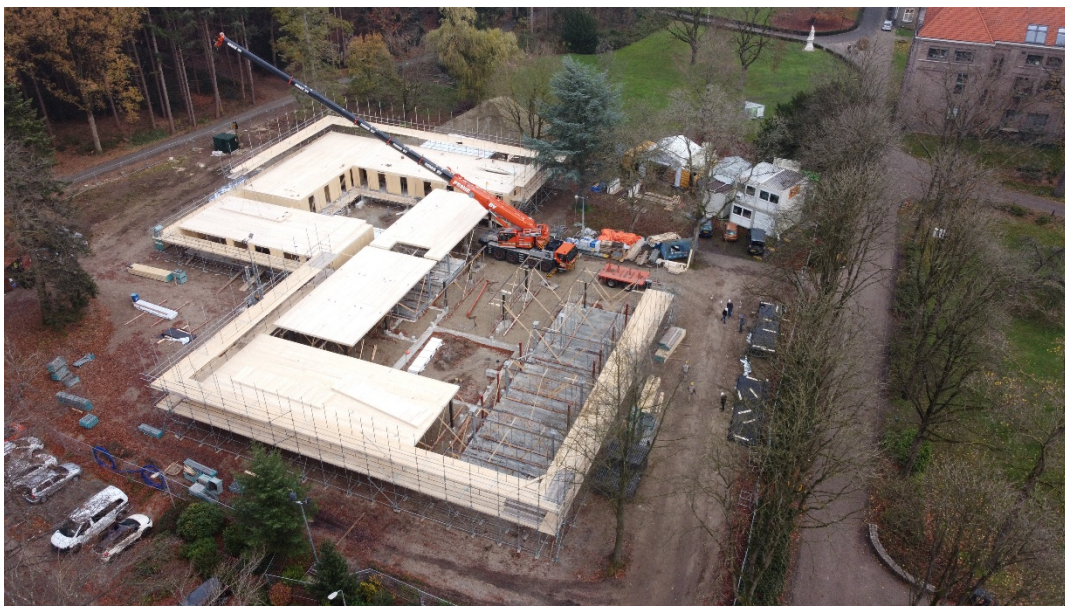
Figuur 3. Montage CLT bij het paviljoen op Landgoed Eikenburg. Foto: FAAM architects
