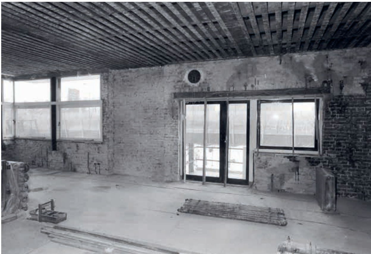
14. Bij de restauratie van de bovenverdieping van het Rietveld Schr derhuis, in 1985-1986, heeft Bertus Mulder wanden en plafond volledig gestript (Bertus Mulder archief)
