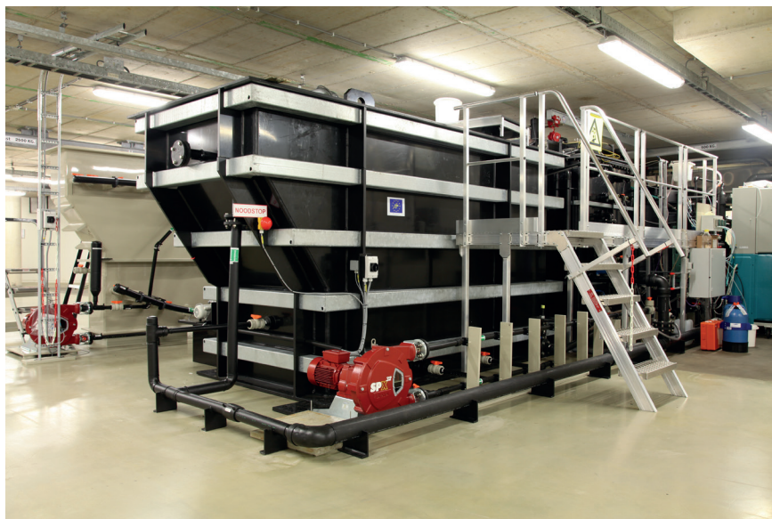
DEMONSTRATIE INSTALLATIE OP RWZI DOKHAVEN
