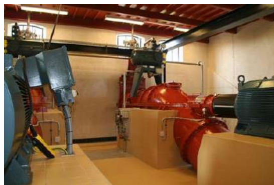
Figuur 3.4: Horizontale pompopstelling gemaal Nieuwkoop (Waterschap Rijnland, 2019)
