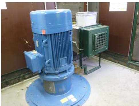
Figuur 3.3: Verticale pompopstelling gemaal Plukmade op 20-11-2018
