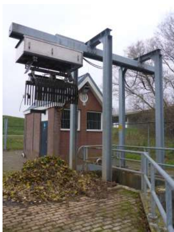
Figuur 2.4: Gemaal Middelschans op 20-11-2018
