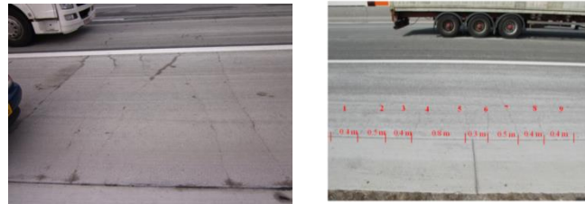
Figuur 5. Y-scheuren (links) en cluster van scheuren (rechts) op de E17 bij Gent.
