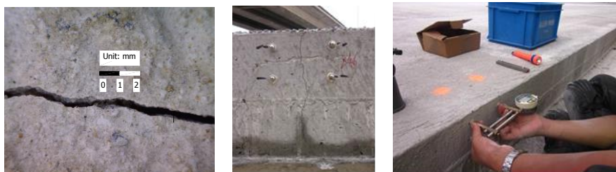
Figuur 8. Scheurbreedtemeting aan het verhardingsoppervlak met een digitale microscoop (links) en meting van de scheurbreedteverandering aan de rand van de verharding met een LVDT (midden en rechts)
