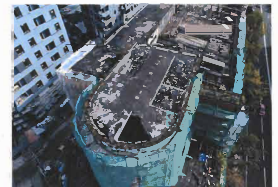
Figure 11: 「レッド・バーナーテキスタイル工場」の発電所の破壊された状況 (2017年9月16日土曜日); ICOMOS (Russia, 2017); 遺産の危機; 建築複合施設「レッドバナー」の保護のための公共事業主体 (Public Initiative for the protection of the architectural complex 'Red Banner' 撮影)
