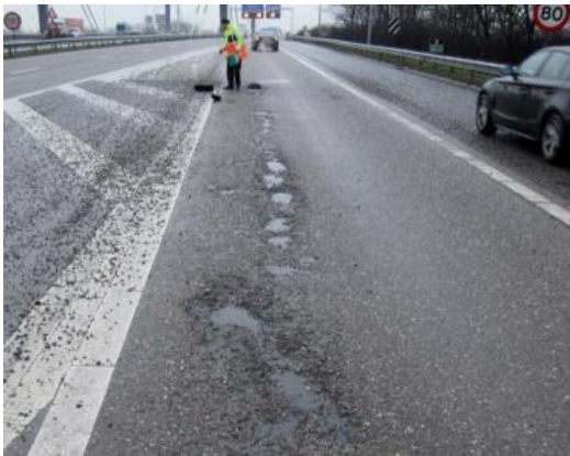
Figure 2-7: Typical example of frost damage in asphalt (De Jong, ZOAB vorstschade en onderhoud, VBW-Asfalt, 2009)
