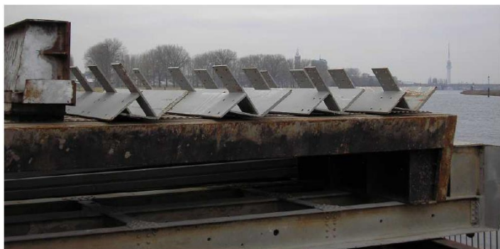
Figuur 55 - Onderhoudselementen Poirée (IV-Infra)
