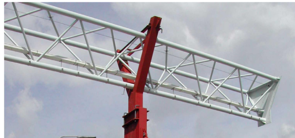
Figure 4.29: Superstructure of a traffic gantry mounted on a temporary column. [source: https://www.gsbirkhoff-staalwerken.nl/projecten/78-tijdelijke-ondersteuning-verkeersportaal ]
