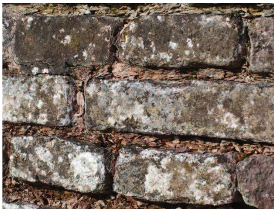
Fig. 12. Metselwerk met Amsterdams of Cazius cement uit 1814 aan de Papsluis in Werkendam (voor de restauratie).
