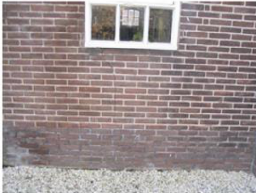
3439 scheur zijgevel schuur.JPG
