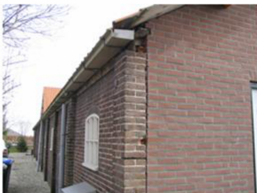
3443 naad zijgevel-achtergevel schuur.JPG
