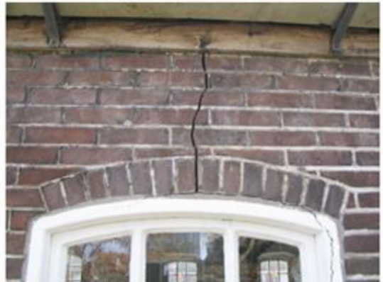
3440 scheur zijgevel schuur.JPG
