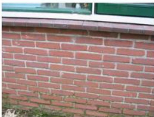
4983 scheurvorming linkerzijgevel voorhuis
