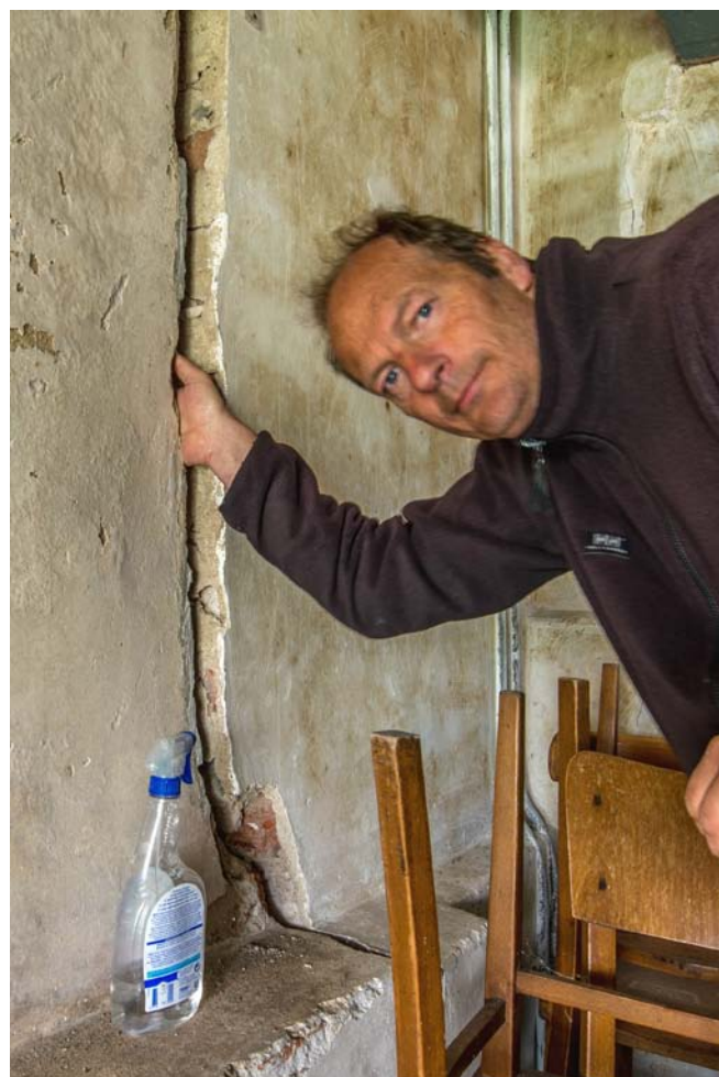
Fig. 11 Jos Stöver van de Rijksdienst voor het Cultureel Erfgoed steekt zijn hand in een brede scheur in het muurwerk op de plek waar de oostgevel van de toren aansluit op de westmuur van de kerk. Foto (met zelfontspanner) J. Stöver, mei 2015.
