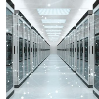
Edge Data Centre
