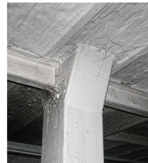
Decombinatie van betonkolommen met stalen liggers en baksteen troggewelven geven een aparte combinatie. Hier is de 'versmelting' duidelijk leesbaar.
