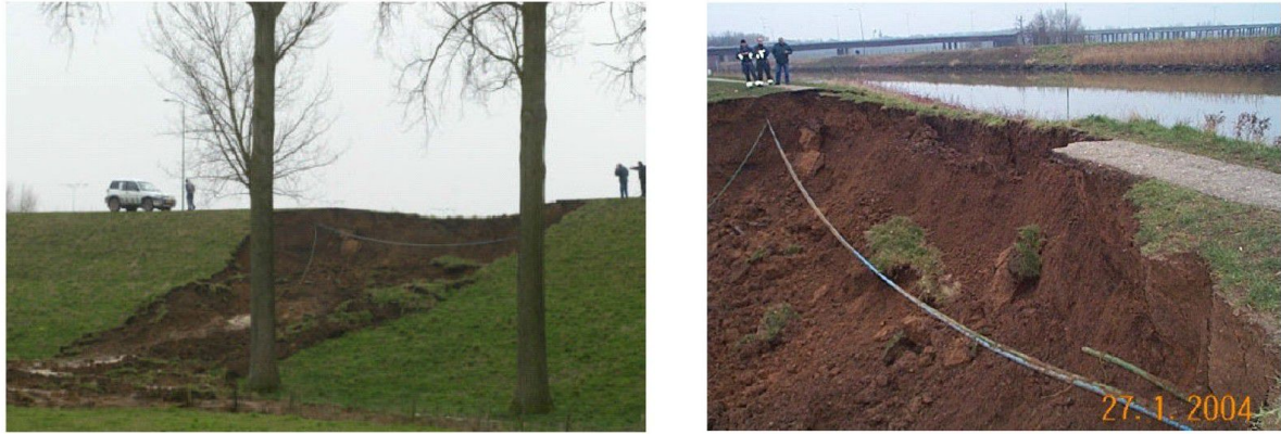
Figure D.1: Resulting failure of the water pipe leakage at Stein. ( Onderzoeksraad voor Veiligheid, 2005 )
