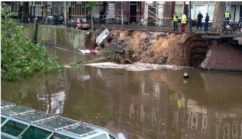
Figure 6.8: Collapsed quay wall of the "Bemuurde Weerd Oost" in Utrecht ( AD, 2013 ).
