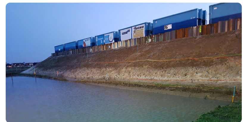
Figuur 1: Eemdijkproef, met damwanden versterkte dijk voorafgaand aan bezwijken. Foto door Arny Lengkeek.
