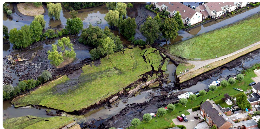
Na een plotselinge dijkverschuiving in augustus 2003, ontstond een gat in de dijk van 60 meter en overstroomde Wilnis. Foto © ANP.
