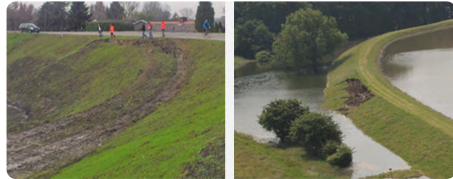
Figuur 2: Voorbeelden van taludinstabiliteit aan de landzijde met en zonder overstroming als gevolg van dijkdoorbraak. Bronnen: Landesbetrieb für Hochwasserschutz und Wasserwirtschaft Sachsen-Anhalt (LHW) en Jüpner et al. (2015).
