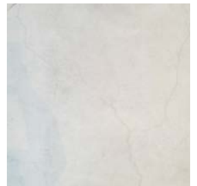
Fare face concrete
